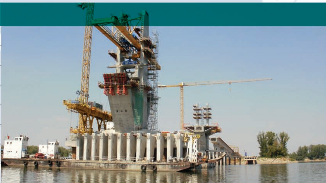
Puente Vidin (Bulgaria)
